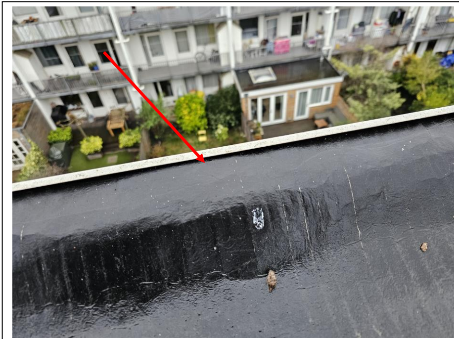
8. dakbedekking ligt los in de daktrim
