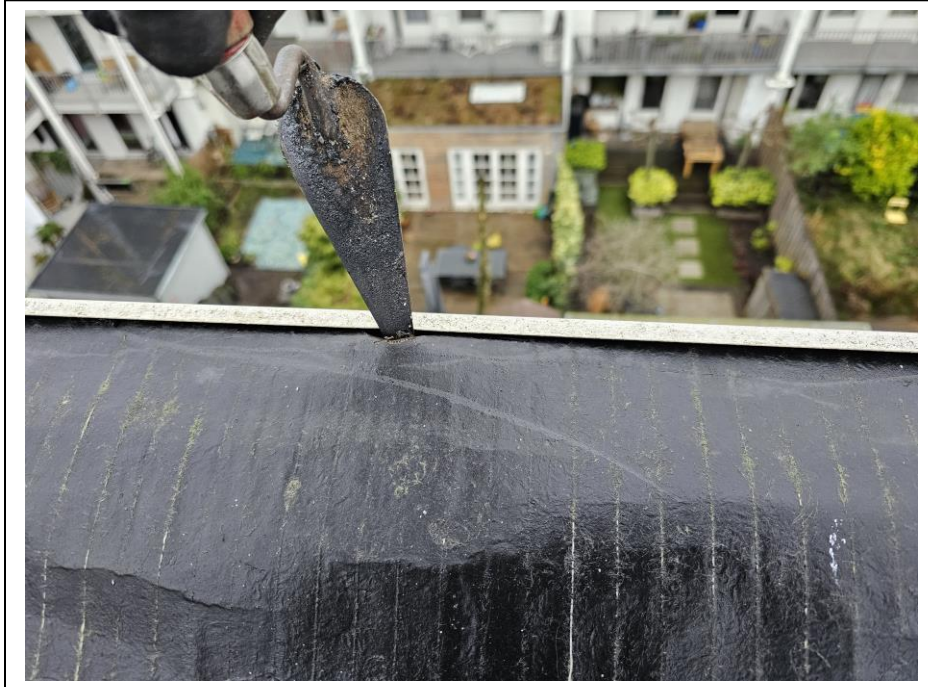
7. dakbedekking ligt los in de daktrim
