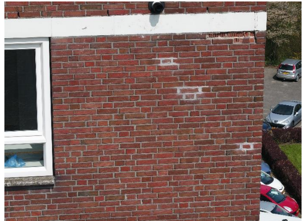
Foto 20: Stenen beschadigd onder balk
