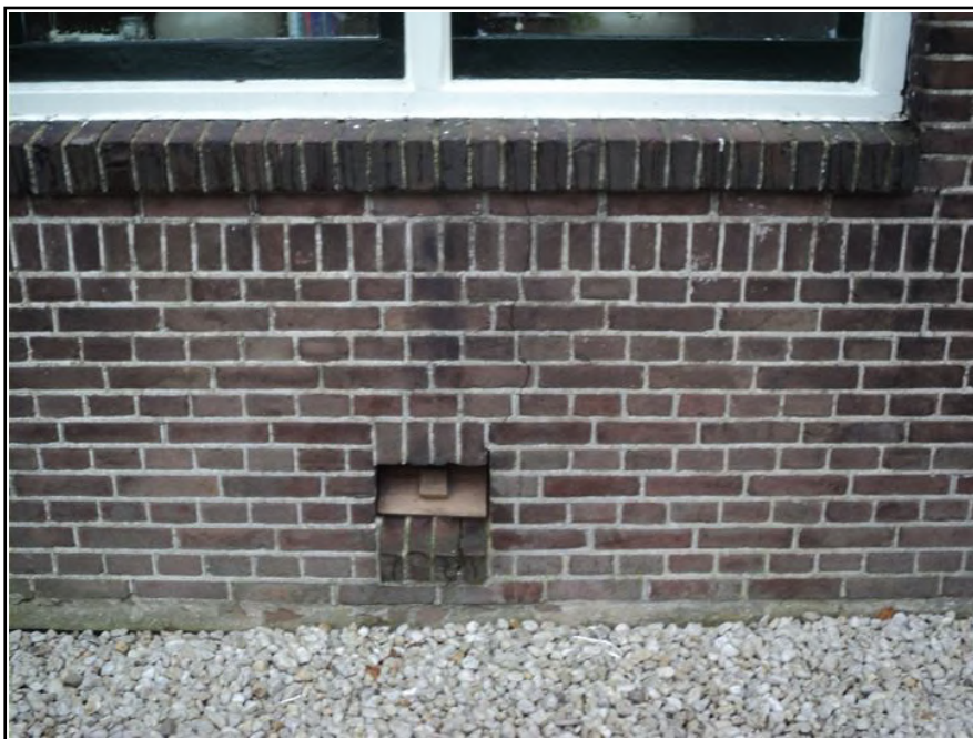
Schade 3, Scheurvorming in gevelmetselwerk, trapsgewijs (53035 (10))
