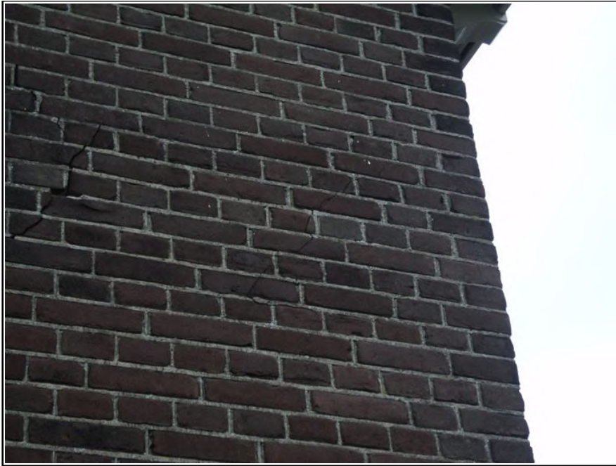
Schade 1, Scheurvorming in gevelmetselwerk 4st trapsgewijs (53035 (9))
