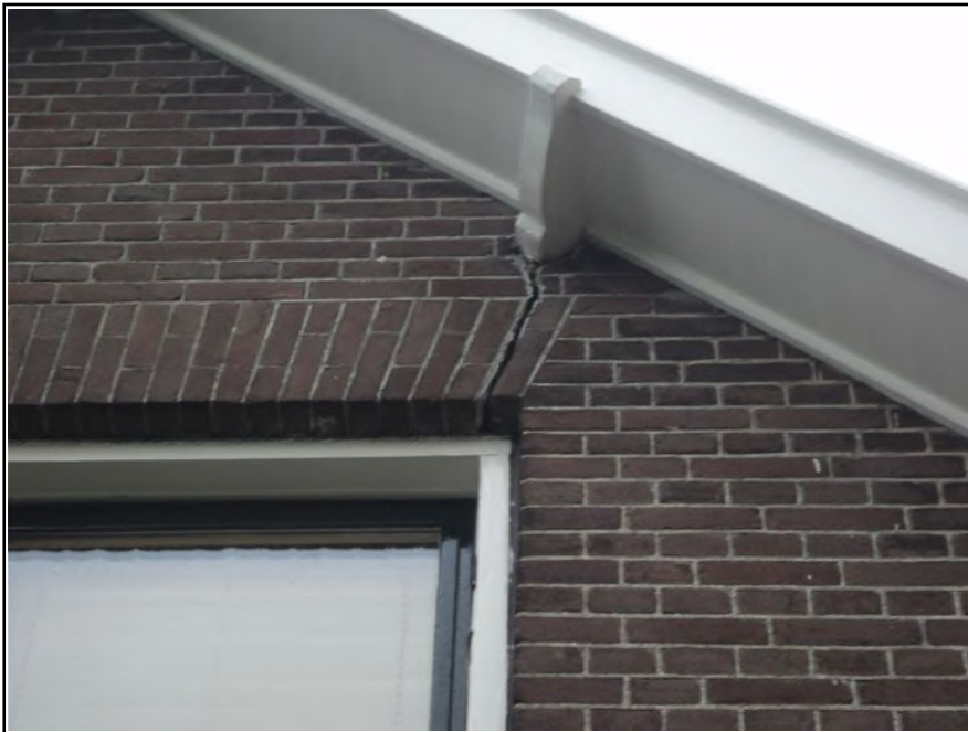
Schade 2, Scheurvorming in gevelmetselwerk, trapsgewijs (53035 (6))
