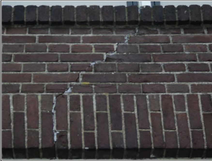
Schade 1, Scheurvorming in gevelmetselwerk 4st trapsgewijs (53035 (7))
