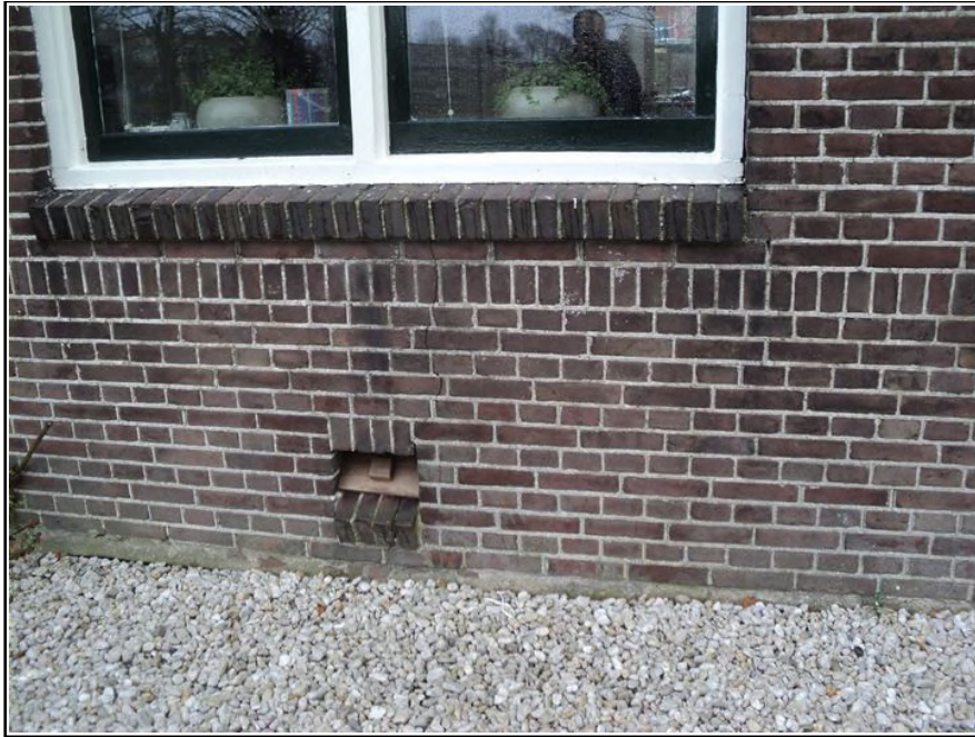
Schade 3, Scheurvorming in gevelmetselwerk, trapsgewijs (53035 (4))
