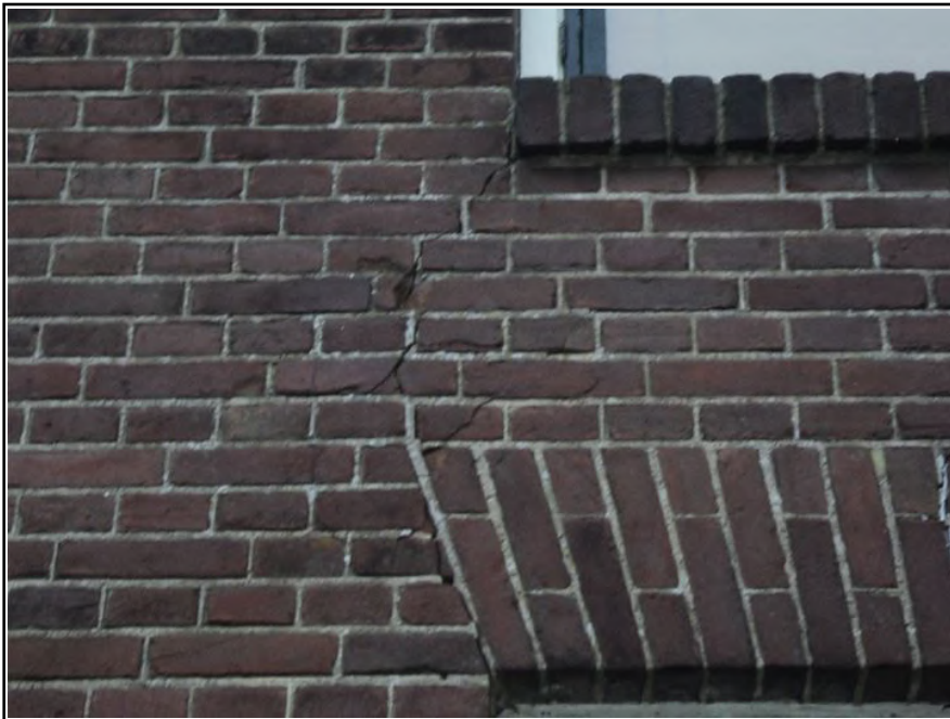
Schade 1, Scheurvorming in gevelmetselwerk 4st trapsgewijs (53035 (8))
