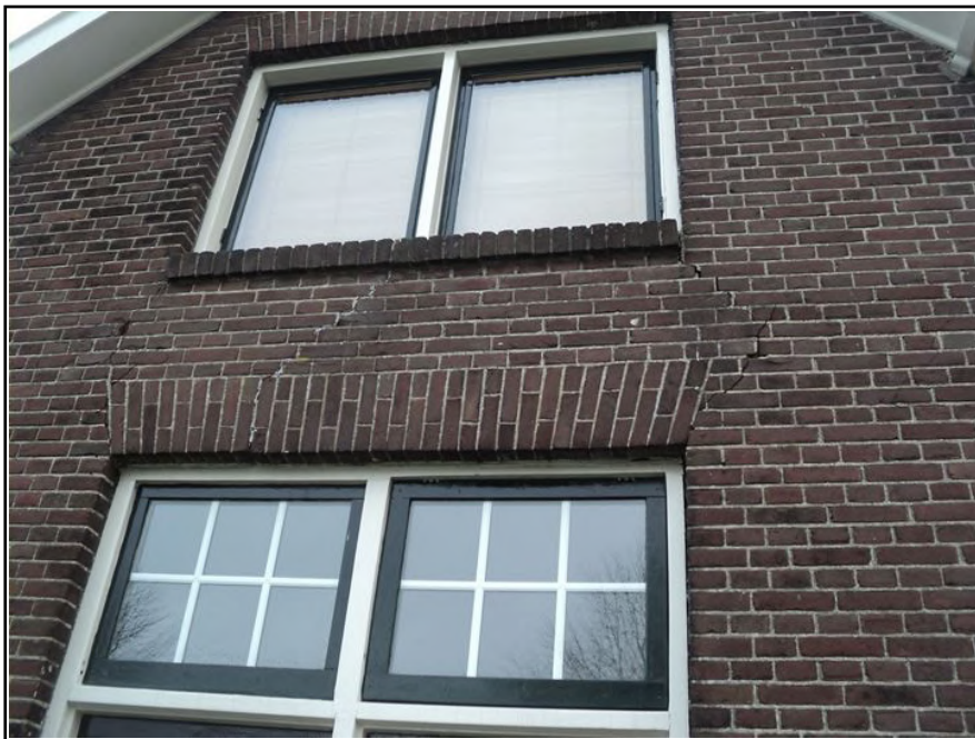
Schade 1, Scheurvorming in gevelmetselwerk 4st trapsgewijs (53035 (3))
