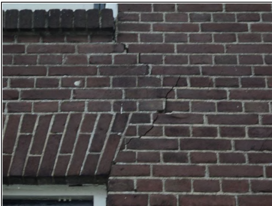
Schade 1, Scheurvorming in gevelmetselwerk 4st trapsgewijs (53035 (5))
