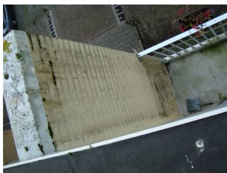
Mosgroei betonafdekker/metselwerk voormalige kolenkast zichtbaar scheur in balkonvloer, ontbreekt waterdichte afwerking.
