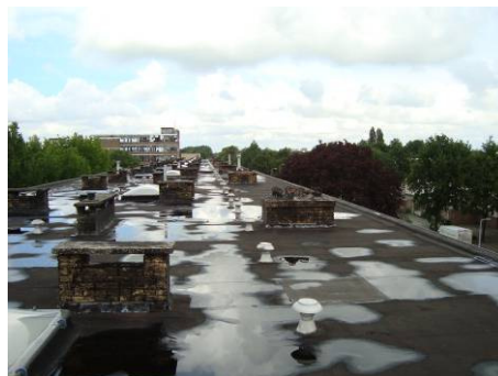
Water op het dak blijven staan
