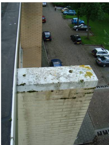
Mosgroei voegwerk Aangetaste betonafdekker
