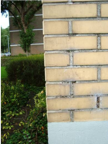
Haarscheuren en slecht voegwerk Langsgevel
