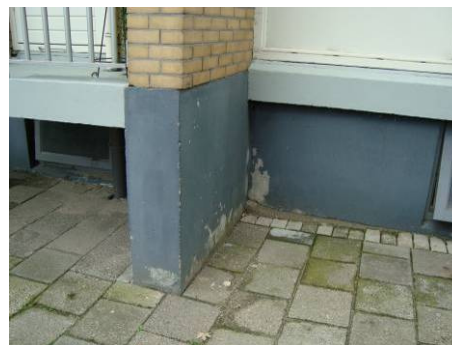
Beschadigde coating souterrain gevel
