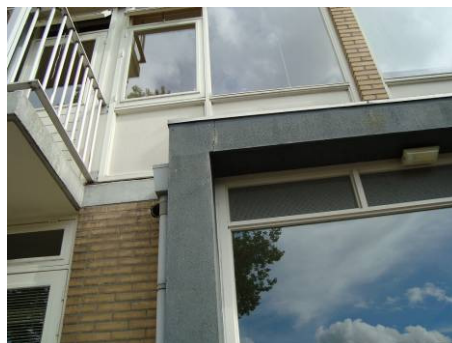
Entreekader (stucwerk) scheurvorming
