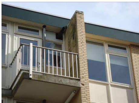
Schade en vervuild metselwerk balkonrand vervuild
