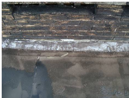
Loodaansluiting gescheurd gecoat metselwerk
