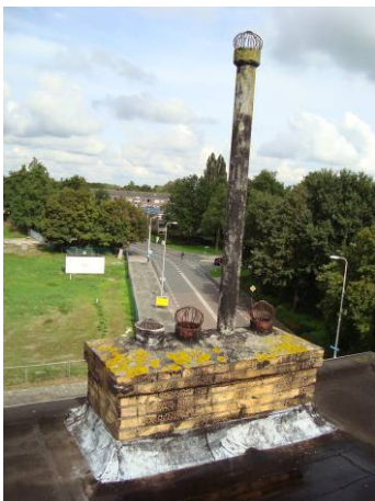
Diverse asbesthoudende bovendakse kanalen
