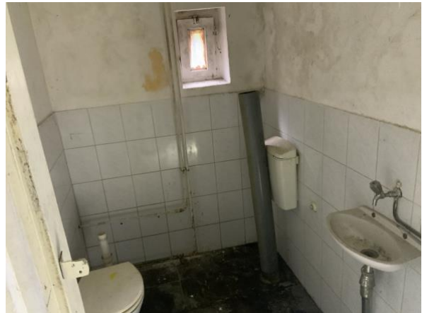
Niet verdachte tegellijm
